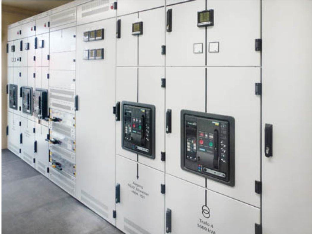
Bild Nr. 48-01 SC_PE-Schaltanlage.jpg.
