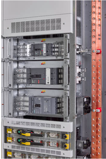
Bild Nr. 50-05 SC_FB-SMU-Feld-bestückt.jpg. Steckmodule mit Kompaktleistungsschalter eingebaut im Feld.
